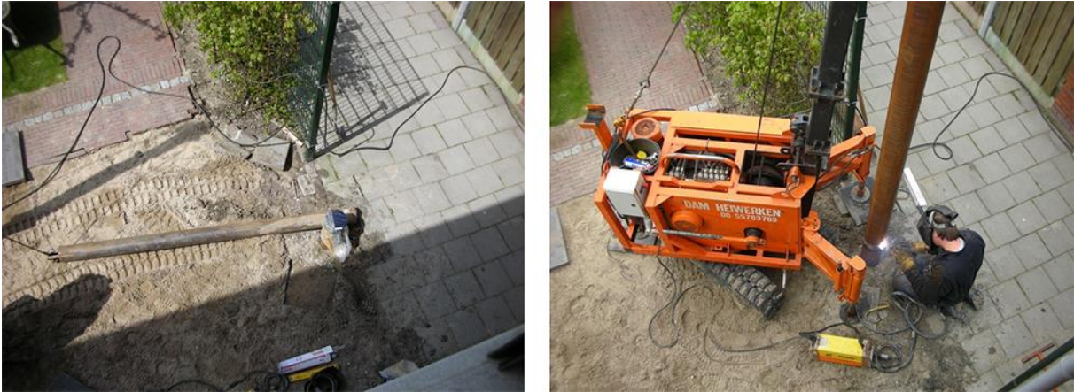
Afbeelding 5 Valblok (links) en laswerk (rechts)
